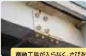
電動工具が入らなく、さびを完全に除去できない部位
