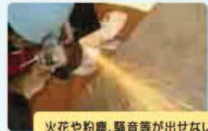
火花や粉塵、騒音等が出せない作業環境でさびを完全に除去できない部位
