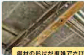
鋼材の形状が複雑でさびを完全に除去できない部位
